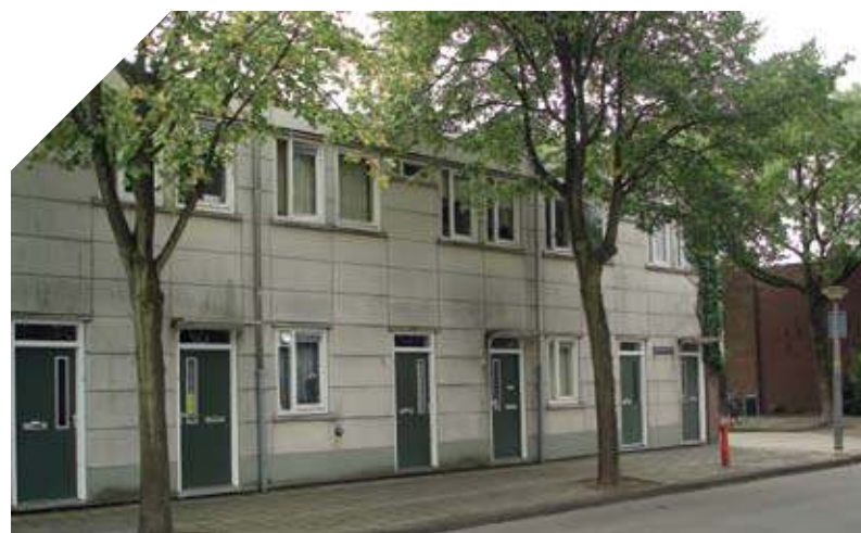
De woningen zijn toe aan groot onderhoud.
