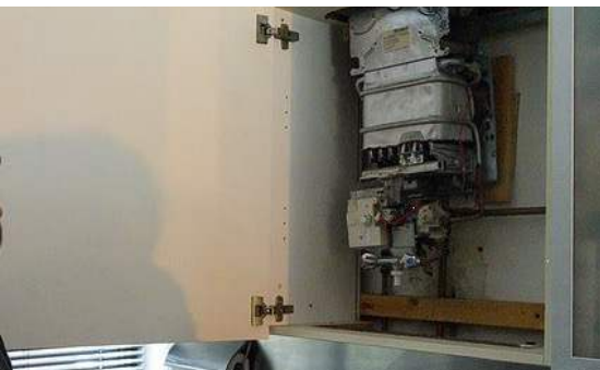
Open geiser in een huurwoning.
